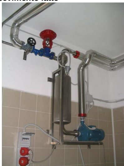
Preparazione acqua calda
